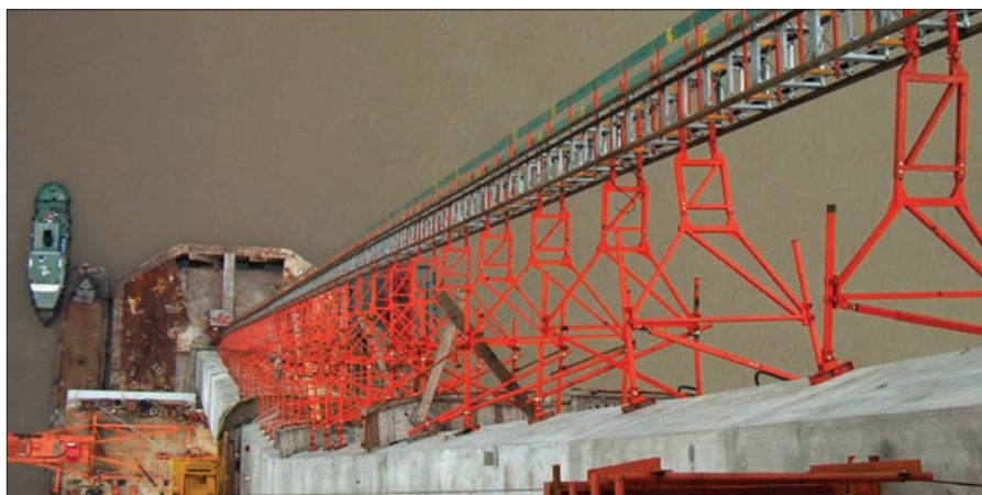
Fig. 10 - Vista delle fondazioni con le zone deputate all'assorbimento di eventuali urti con navi
