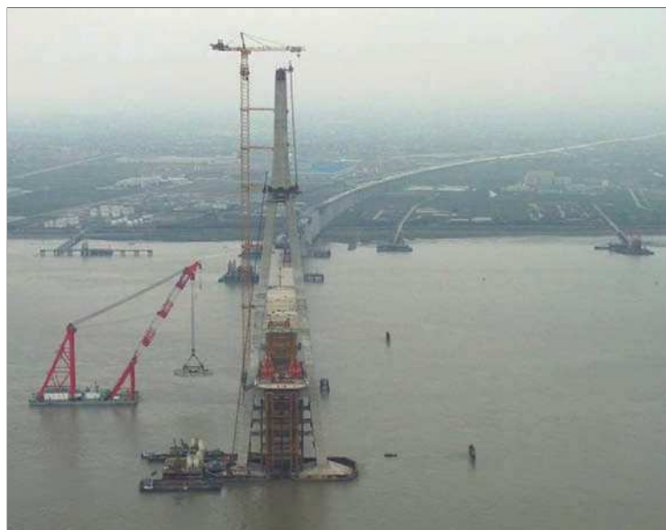
Fig. 8 - Vista dalla testa dell'antenna a 306 m d'altezza
